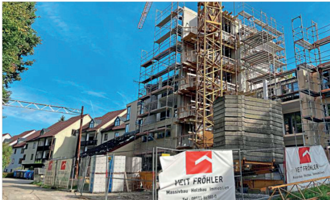
Baustelle: Das Studentenwerk Niederbayern/Oberplatz erweitert das Wohnrahn an der Leonhard-Paminger-Straße. Zusätzliche 98 Wohneinheiten entstehen.
